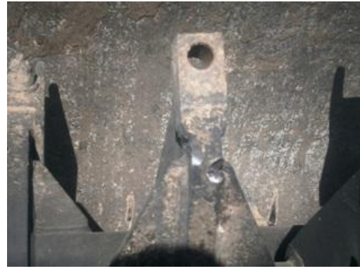
Dégâts après détonation d'une MAC
